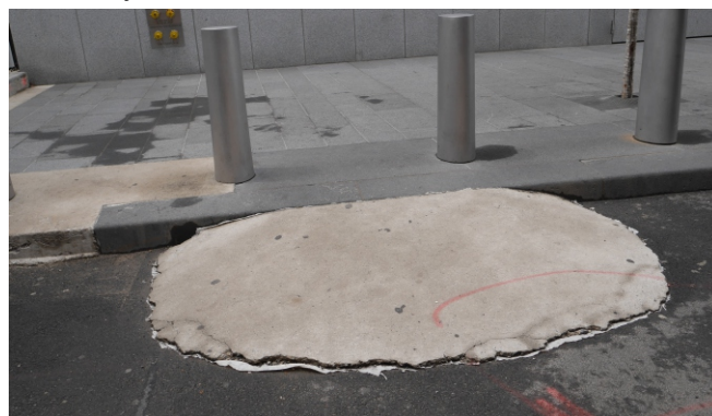
Ryc. 10.2. Na obejściach należy umożliwić zjazd z chodnika poprzez wykonanie tymczasowych pochylni/zjazdów (autor: M. Wysocki).
